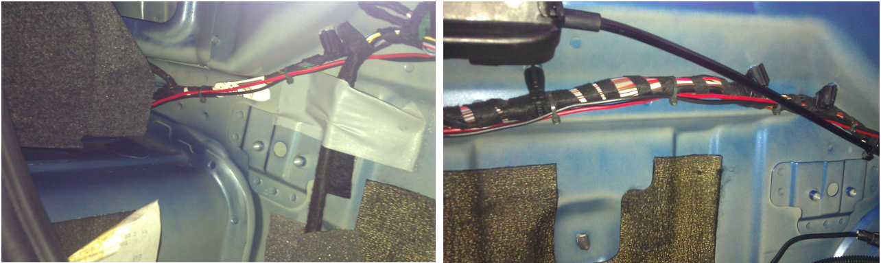
[Bild 13 und 14: Schalt- und Massekabel für das Relais an der Rückwand rechts und links]
